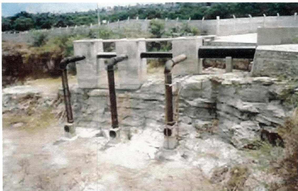
Figura 3.5 – Detalhe do dispositivo de entrada da lagoa anaeróbia.
