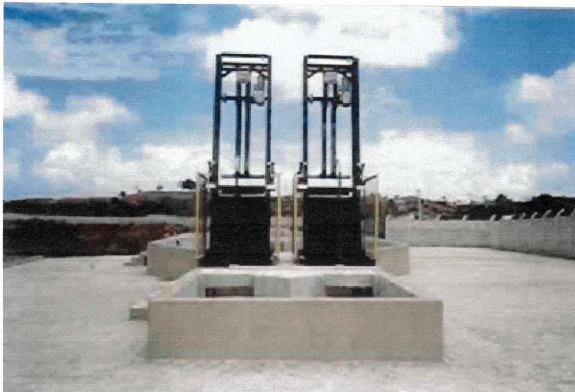
Figura 3.3 – Caixa de areia e grade de barras mecanizadas.
