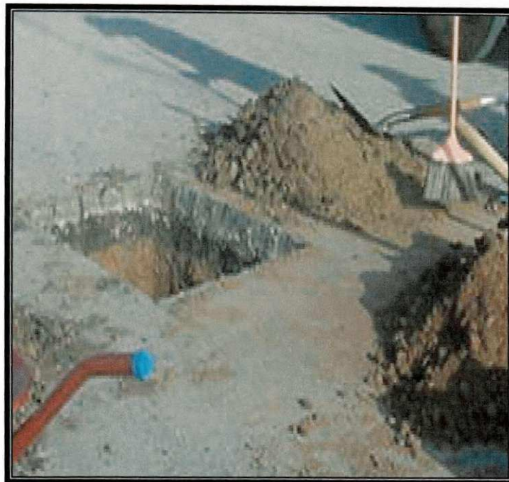
Figura 3.3 – Poço de inspeção (PI - 105) - retirada da camada de base e sub-base, e coleta de amostras do material do subleito para ensaios em laboratório.
