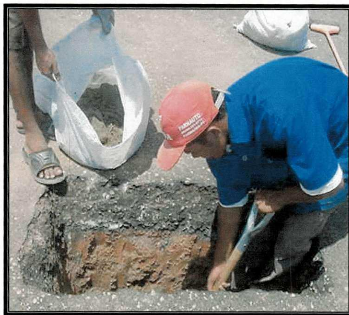
Figura 3.5 – Poço de inspeção (PI - 103) - realização de coleta de amostra de material do subleito.
