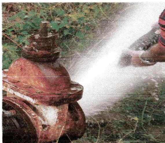
Figura 4.16 – Detalhe da coleta na válvula de descarga da adutora de DN500 mm.
