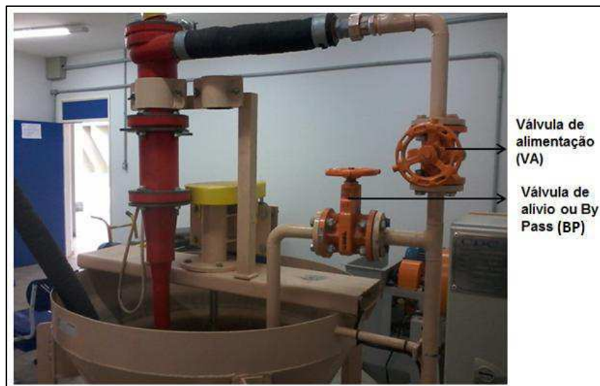
Figura 18 - Válvulas de operação da unidade piloto de hidrociclonagem do IFPB, campus Campina Grande
