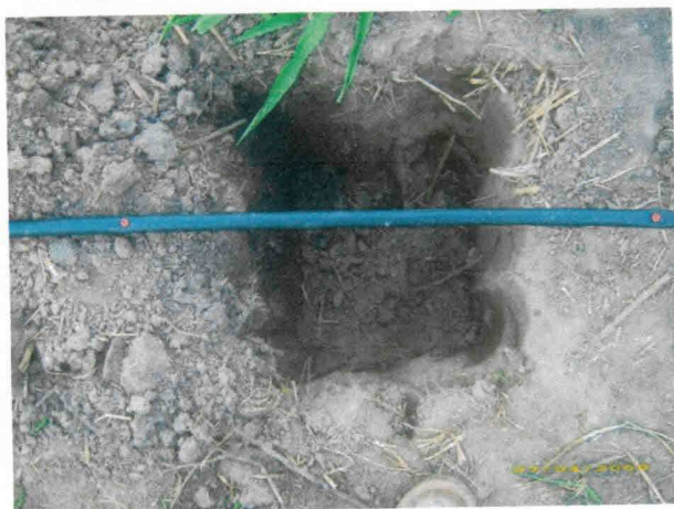
Coveamento e tubulação 16mm com gotejadores
