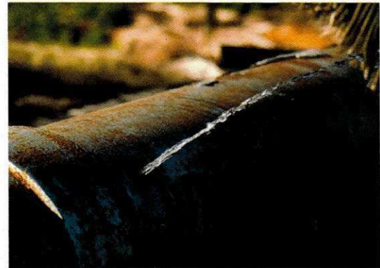
Figura 2.7: Vazamento observado em um trecho de tubulação com sinais de corrosão. Fonte:
