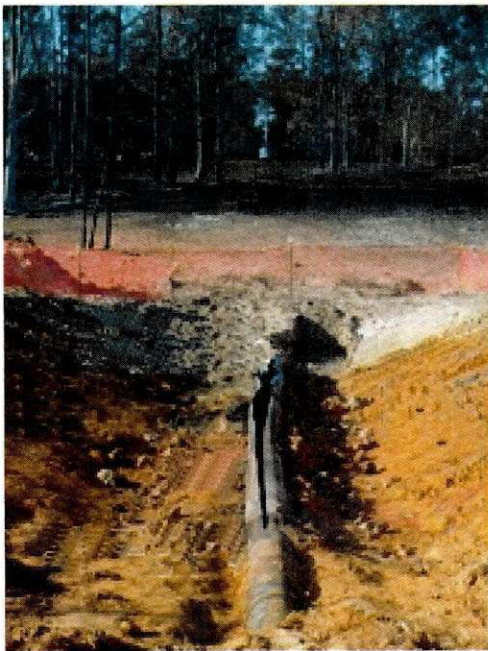
Figura 2.8: Gasoduto subterrâneo rompido em 2007 nos Estados Unidos. Fonte: NDTcabin, 2010.
