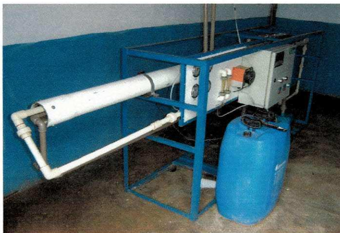
Figura 3.2- Sistema de Dessalinização de Riacho de Santo Antônio-PB, (Tanque Raso)
