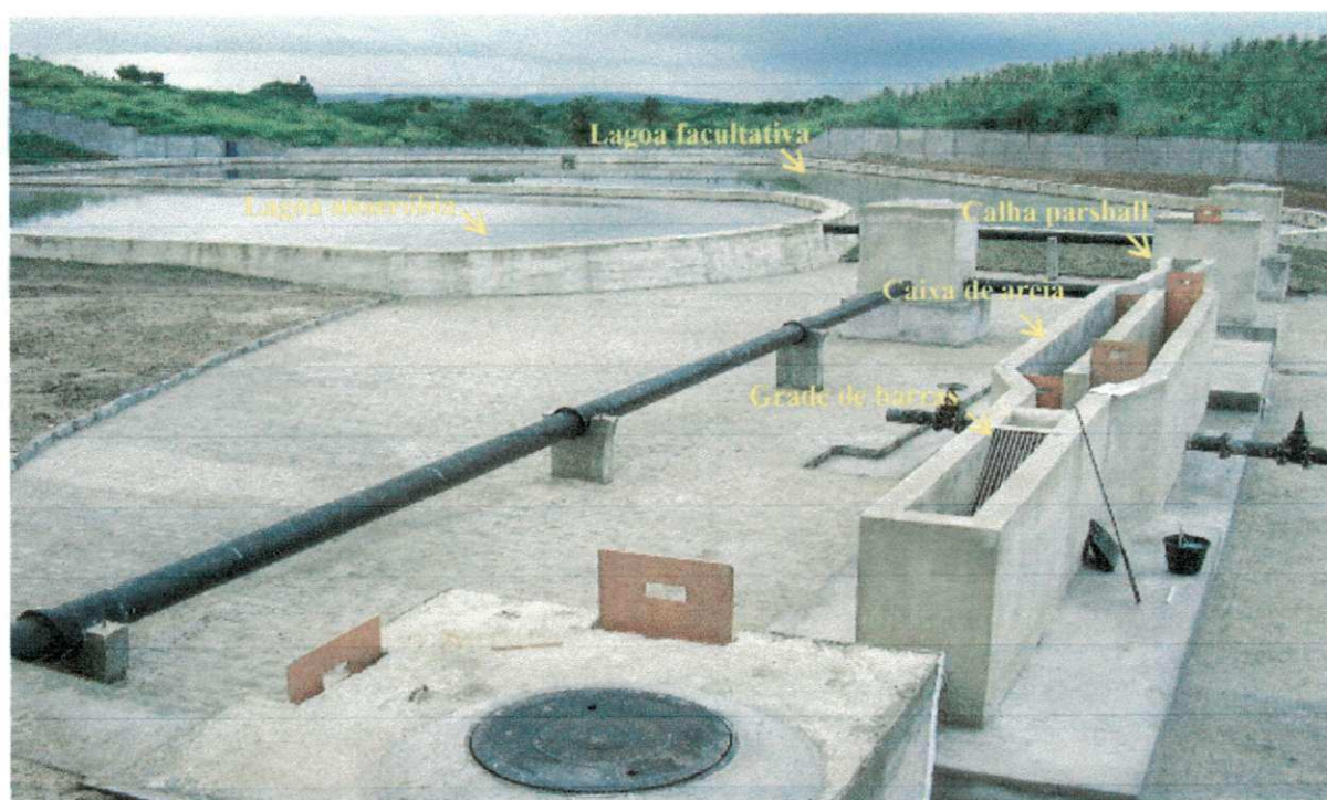
Figura 3.2 – Vista geral das unidades de tratamento da ETE.
