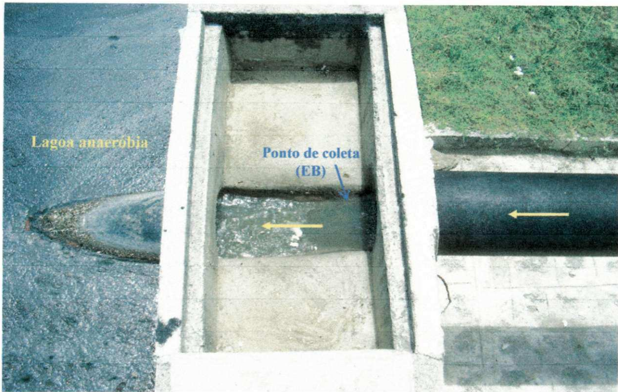
Figura 3.6 – Alimentação da lagoa anaeróbia.
