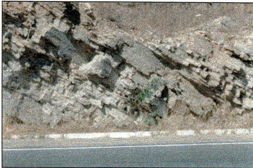
Figura 15 – Fraturas regionalizada observada nos quartzitos na BR – 230 (Serra de Santa Luzia – PB).
