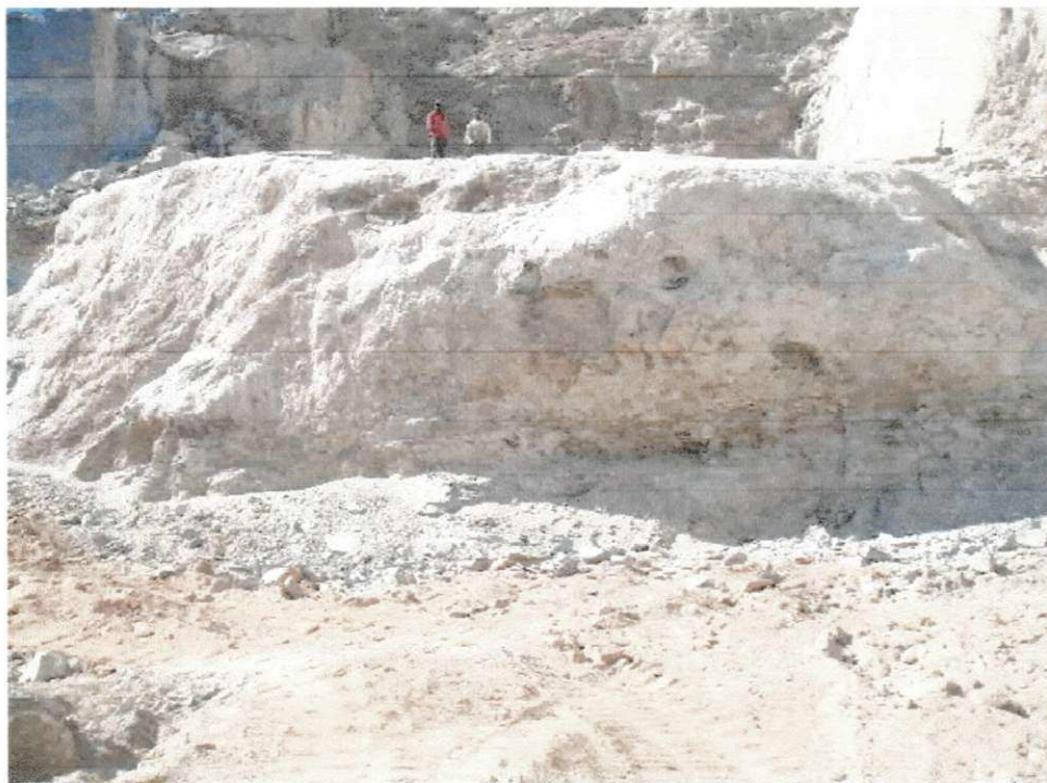
Foto 16 - Frente de rocha sã onde será iniciado o processo de formação de “pranchas” para confecção dos blocos.
