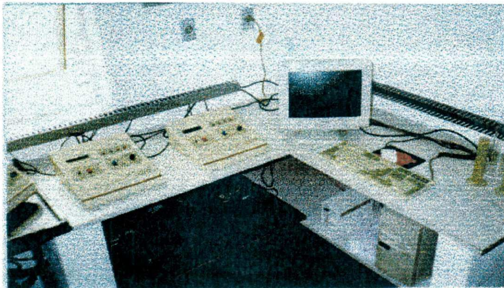
Figura 4.7 - Fotografia dos 2 (dois) microcontroladores (lado esquerdo do monitor) instalados na ETE da CETREL.
