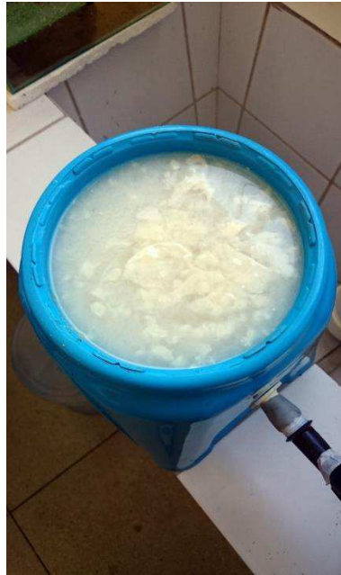
Figura 18 – Caixa de distribuição obstruída por material flutuante.
