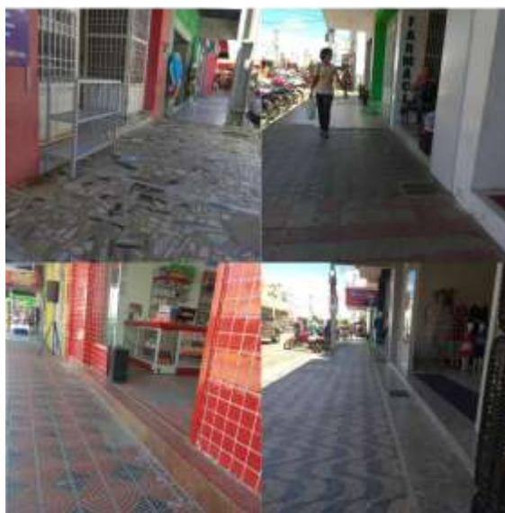
Figura 15 - Fotografia "Desnível em comércio"
