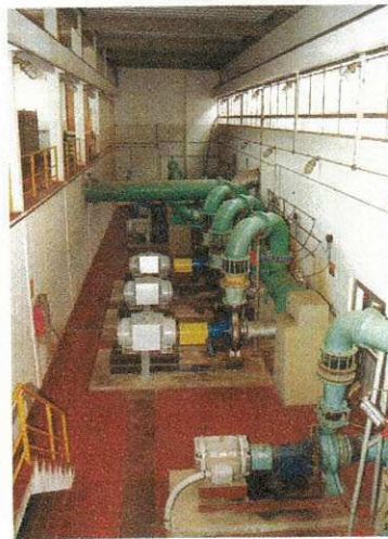
Figura 2.22 - Vista do conjunto de bombas peristálticas na Sanepar.
