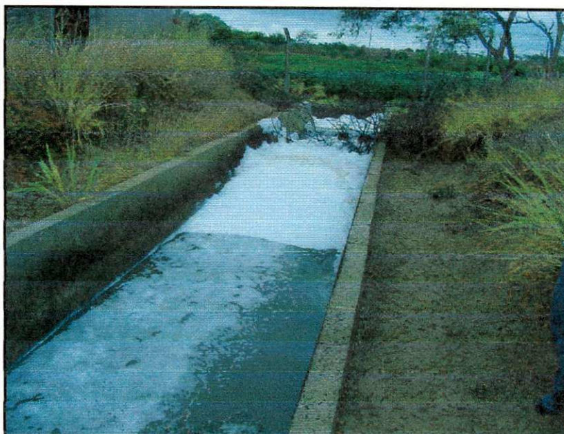
Figura 4.3 - Vertedouro de saída do efluente final da ETE de Campina Grande, PB
