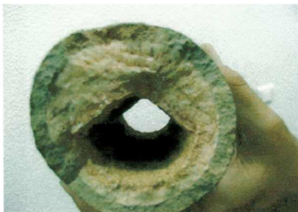
Figura 2.2 - Degradação do diâmetro interno na tubulação por deposição de cal e variação da rugosidade 3
