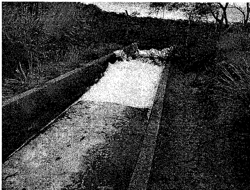
Figura 3.5: Vertedouro de saída do efluente final.
