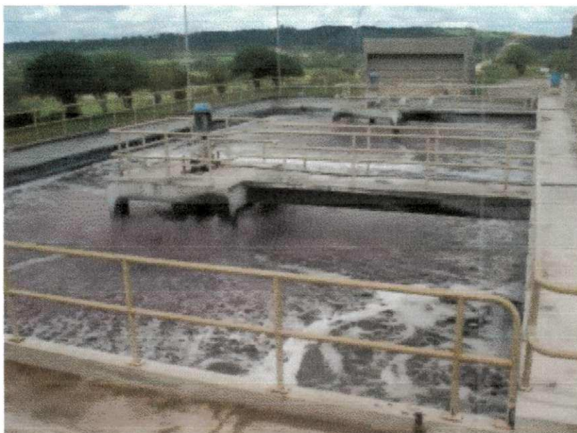
Figura 2.4 – Parte da estação de tratamento de efluentes (ETE) da COTEMINAS, decantador secundário.
