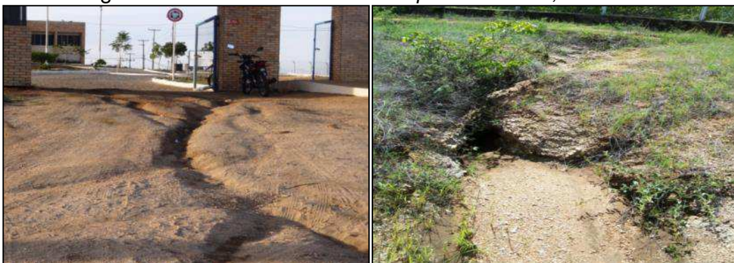
Figura 1 - Erosão na área do Campus da UFCG, em Pombal - PB
