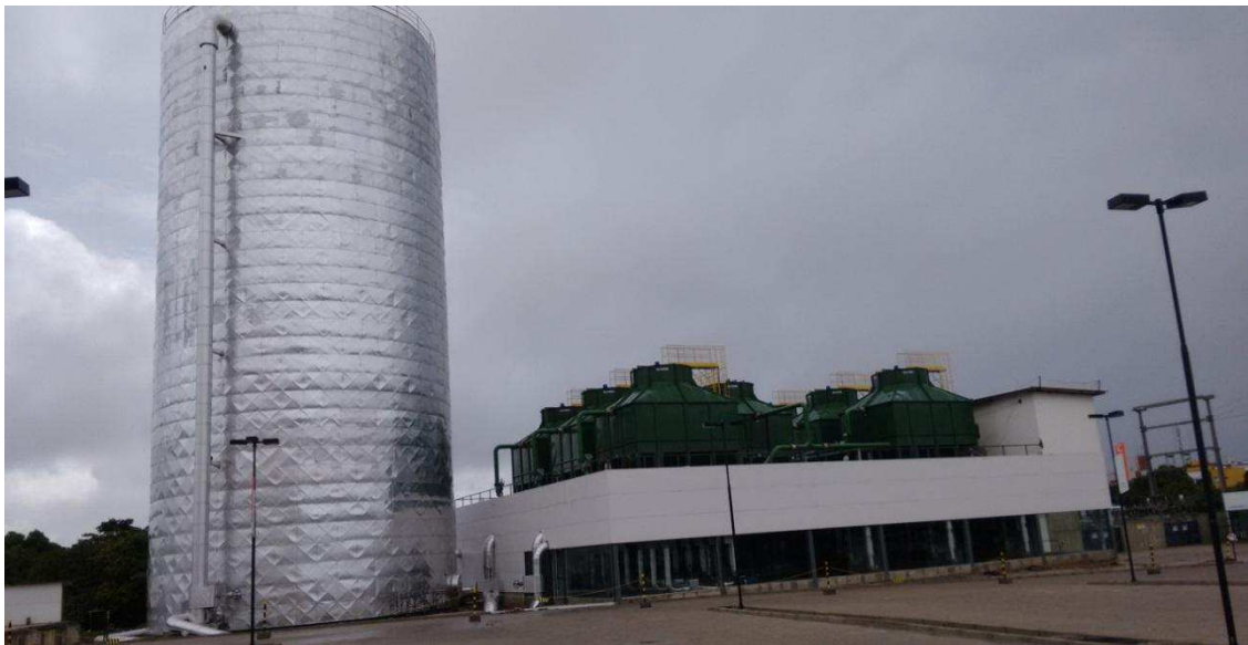
Figura 5.2: Central de água gelada onde o equipamento se encontra.
