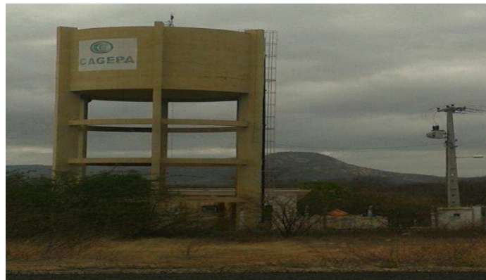
Figura 3 - Caixa d'água que abastece o Distrito de Ipueiras
