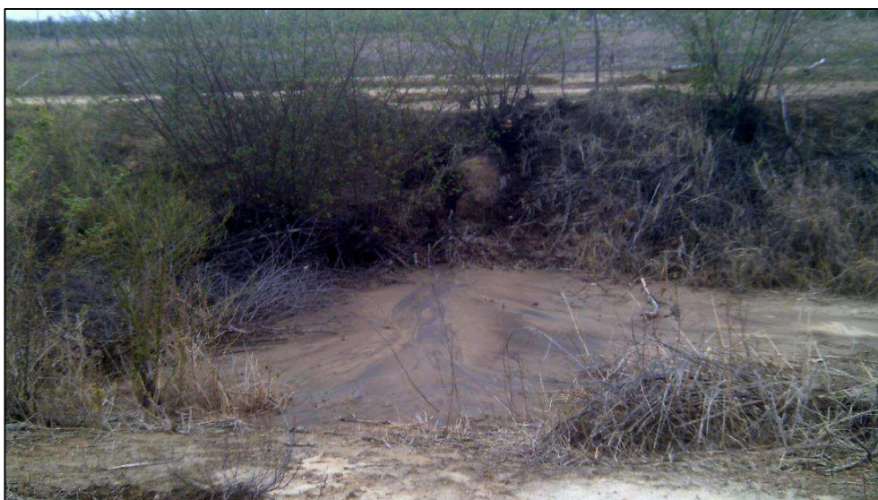
Figura 7: Dreno do PISG.
