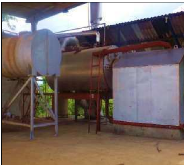
Figura 14 - Gerador de vapor da empresa
