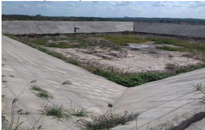
Figura 6 - Lagoa anaeróbica do 2º módulo
