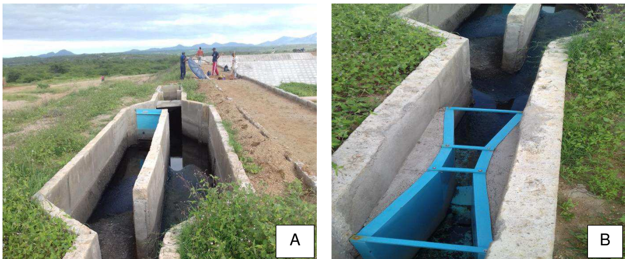
Figura 4 - Tratamento preliminar: (A) Grade e caixa de areia; (B) Medidor de vazão
