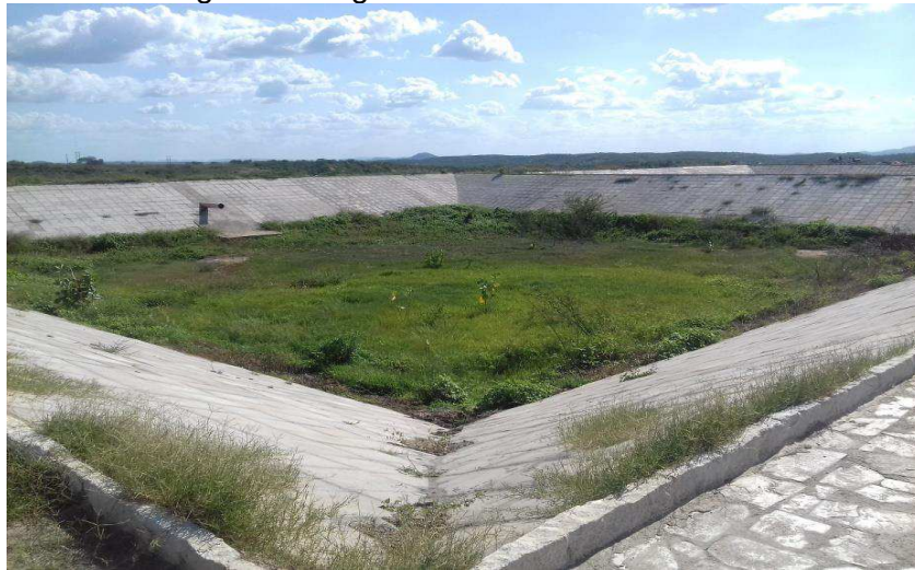
Figura 5 - Lagoa anaeróbica do 1º módulo
