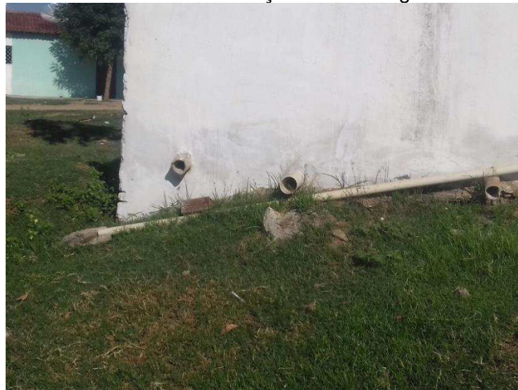
Figura 30 - Residência com Lançamento de esgoto a céu aberto
