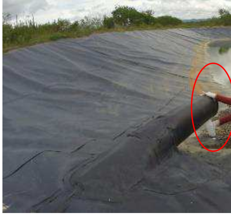
Figura 11 - Coleta de lixiviado do ASCG na tubulação de entrada da LTL 1
