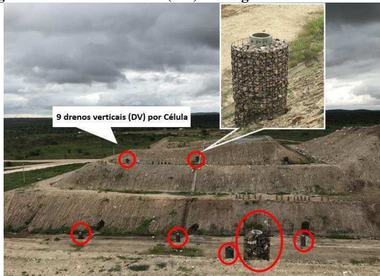
Figura 12 - Drenos verticais (DV) de biogás na Célula 2 do ASCG
