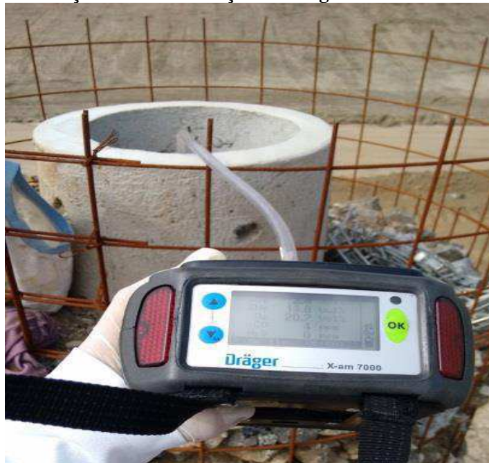
Figura 15 - Medição das concentrações de biogás nos Drenos verticais (DV)
