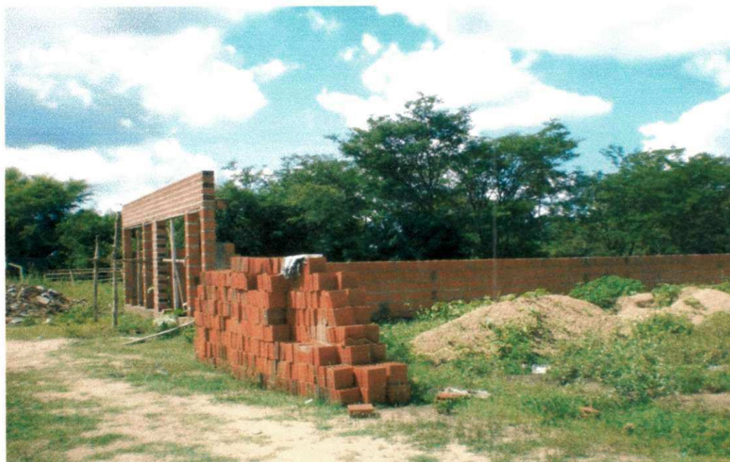
Foto – 09: Construção de casas a margem do Rio Salgado.
