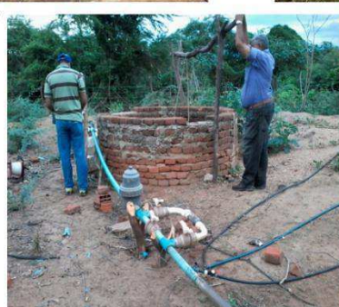
i) Poço P09
