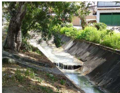
Figura 35 — Desnível na calha do Riacho das Piabas
