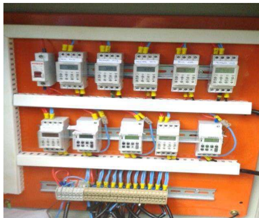
Figura 3.3 - Temporizadores utilizados para acionamento das bombas
