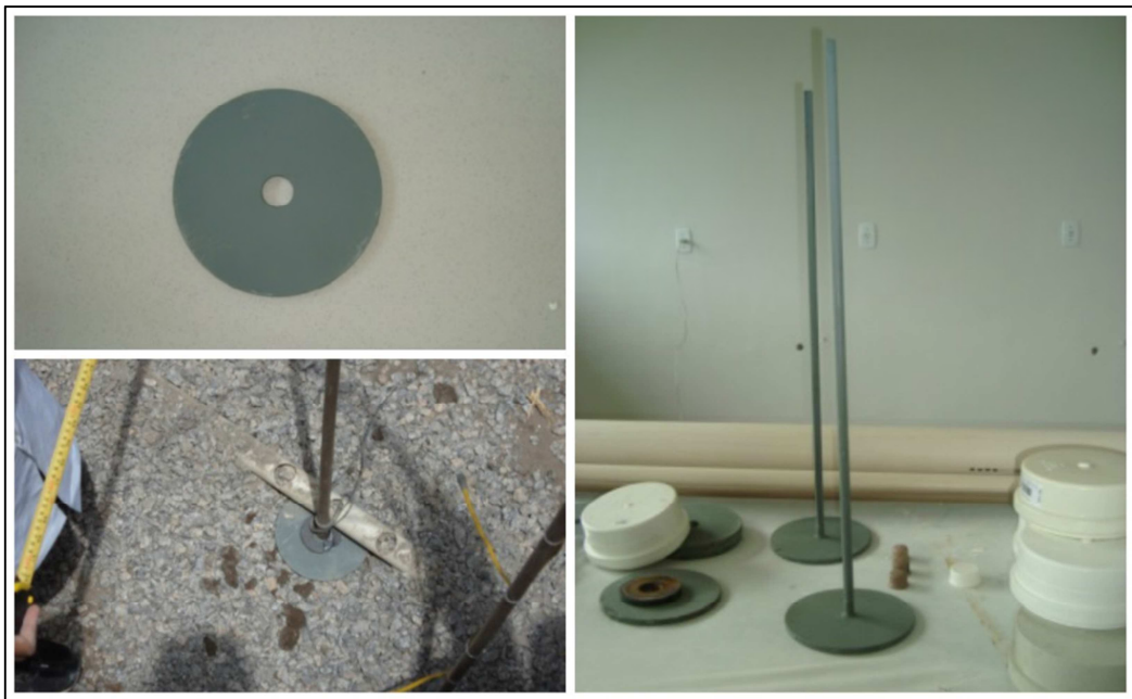
Figura 17 – Placas para monitoramento dos recalques.
