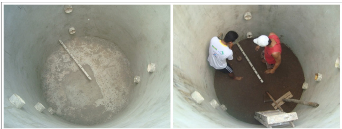
Figura 19 – Dreno de líquidos percolados.
