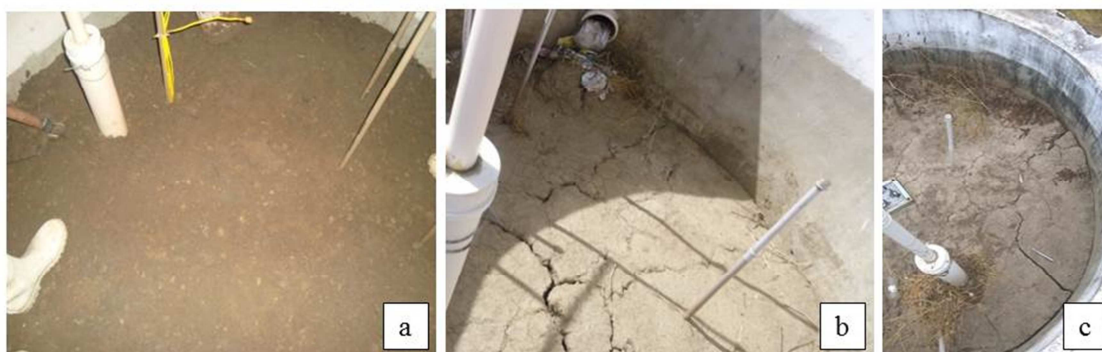
Figura 51 – Camada de cobertura; a: após a operação do enchimento; b: antes da retroalimentação; c: três meses após a retroalimentação.
