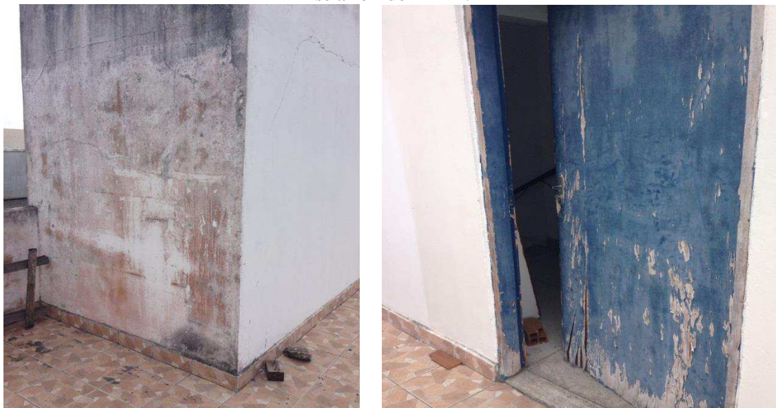
Figura 4.19. Oxidação da pintura sobre o reboco e ação do tempo na porta de acesso ao solário 1 do LEMT.
