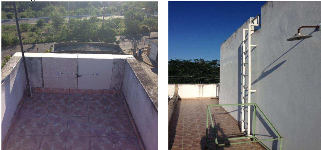
Figura 3.20. Acesso ao solário 02 onde foram instalados os sensores Te5ful e Te6reb .
