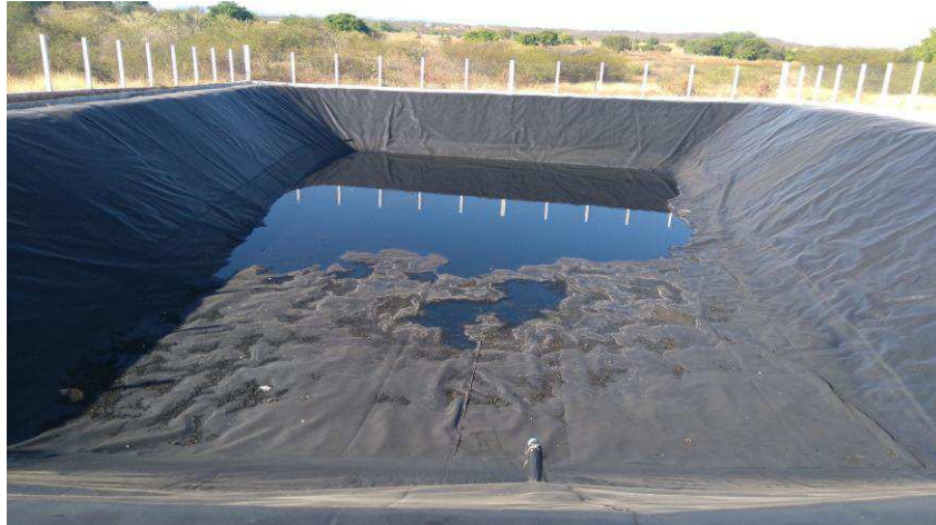
Fotografia 7 – Aterro Trash: Estação de Tratamento e Lagoa de Estabilização Fonte: Dados da Pesquisa (2016)
