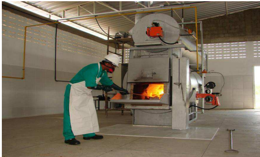
Fotografia 8 – Aterro Trash: Estação de Tratamento do Lixo Hospitalar – Incineração Fonte: Dados da Pesquisa (2016)
