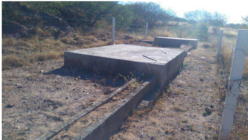
Fotografia 6 – Aterro Trash: Estação de Tratamento e Lagoa de Estabilização Fonte: Dados da Pesquisa (2016)
