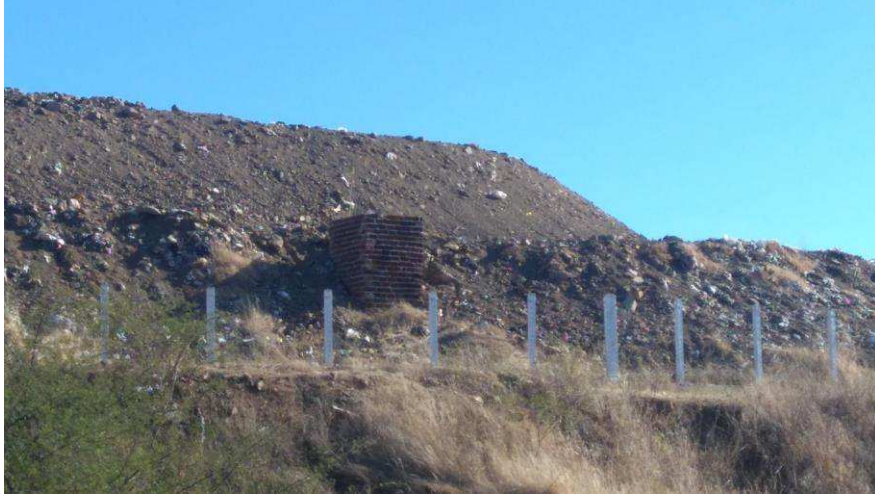
Fotografia 5 – Aterro Sanitário da Trash: caixa de captação do chorume Fonte: Dados da Pesquisa (2016)
