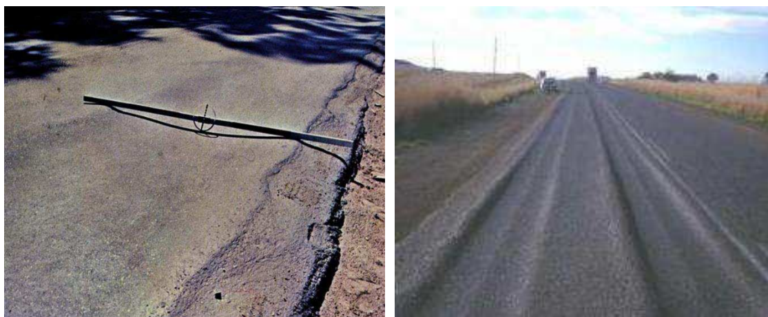
Figura 3 – Afundamento de trilha de roda.
