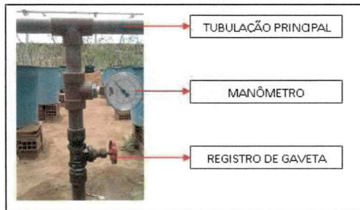
Figura 3: Equipamentos de regularização do sistema de irrigação e tubulação principal
