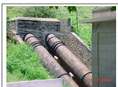
Foto 5 – Tubulação de entrada nas turbinas
