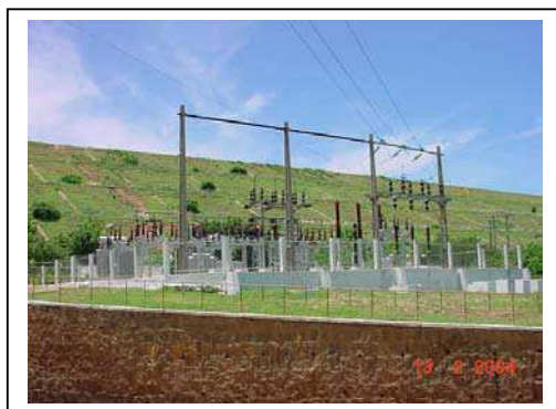
Foto 4 – Sub-estação de transmissão de energia
