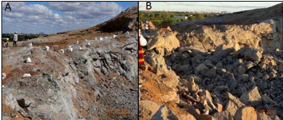
Figura 16 – Desmonte de rocha iniciado por linha silenciosa: talude irregular (A) e blocos fora de especificação (B)
