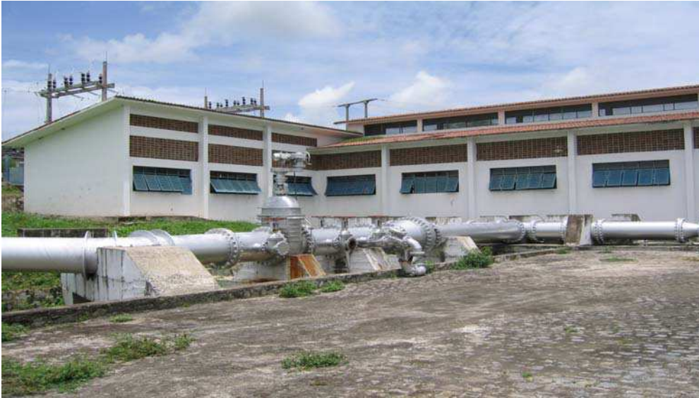
Figura 3.10 – Tubulação de 800 mm na saída da elevatória de água tratada.
