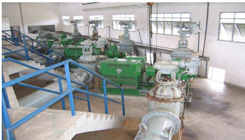
Figura 3.5 – Elevatória de água bruta EEAB
