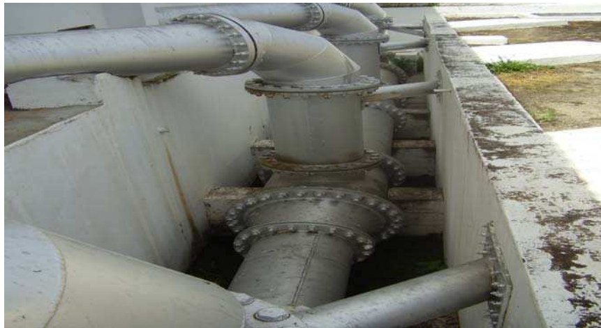
Figura 3.4 – Barriletes de sucção de água bruta EEAB
