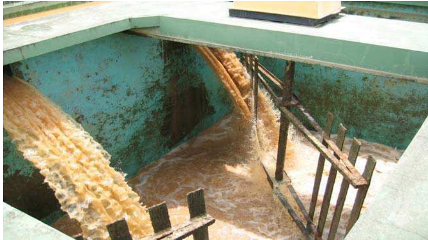
Figura 3.8 – Misturadores de sulfato ETA de Gravatá
