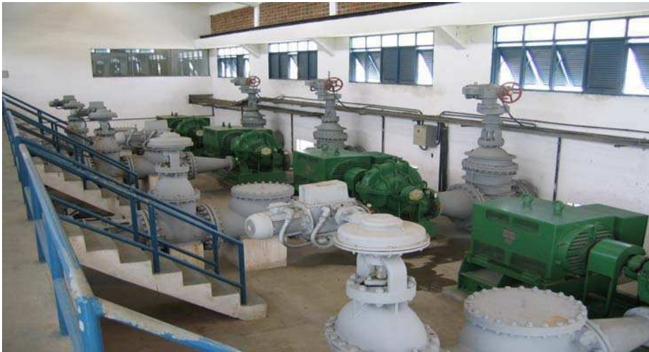
Figura 3.9 – Estação elevatória de 800 mm de água tratada em Gravatá.
