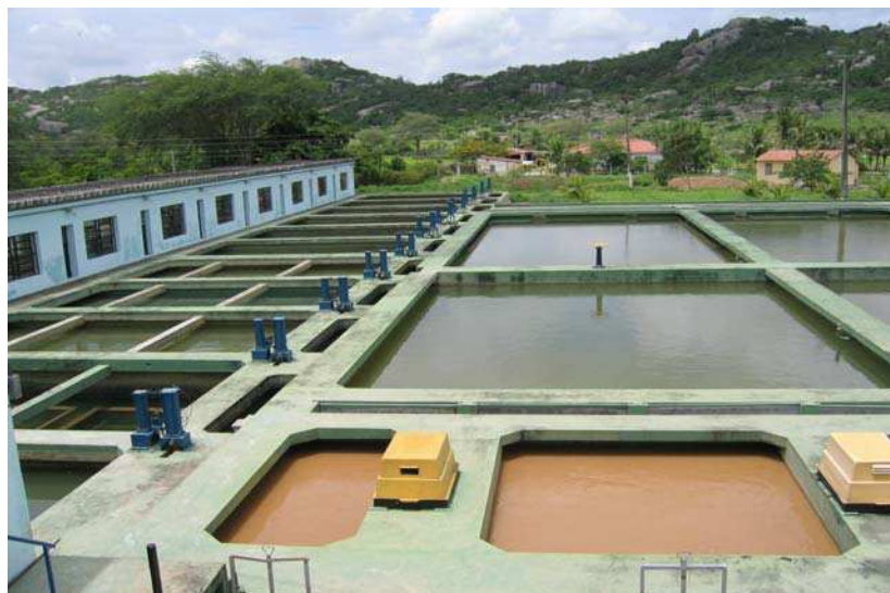
Figura 3.7 – Estação de tratamento de água de Gravatá
