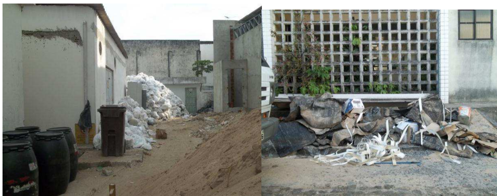
Figuras 16 e 17 – vista parcial da reforma com RSS e material de construção em um mesmo espaço e entulhos e resíduos da reforma predial.
