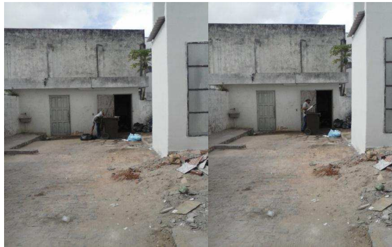
Figuras 23 e 24 – funcionário sem EPI adequado.
