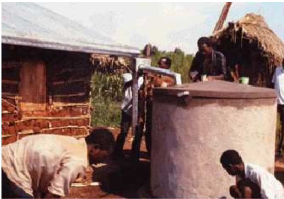
Figura 4.0 -Tanques de armazenamento de água de chuva construídos por pedreiros locais no Quênia. Fonte - UNEP, 2002
