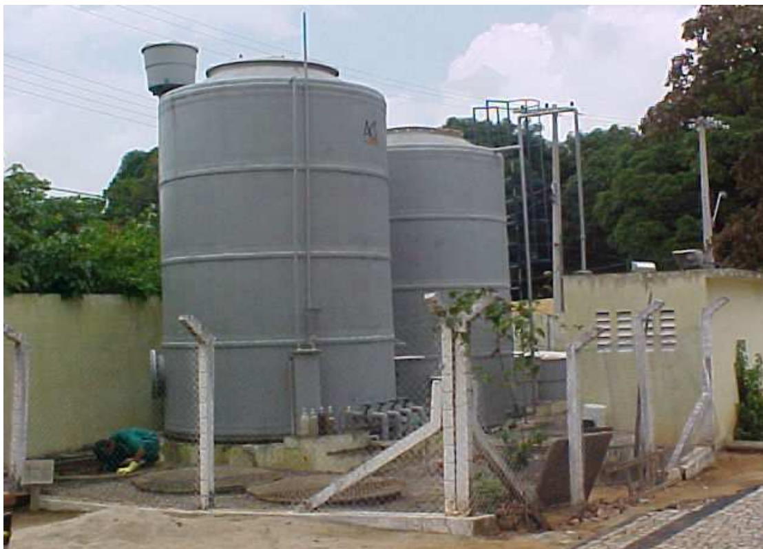
FIGURA 6.3 - Vista da ETE do HGWA
