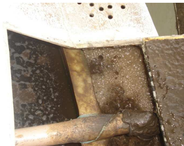
FIGURA 6.12 – Retorno de lodo decantado
