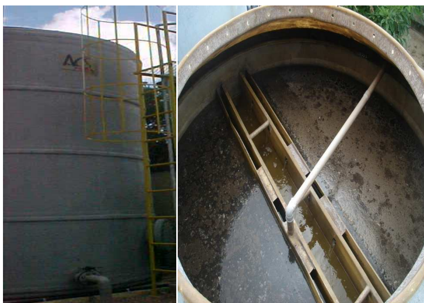
FIGURA 6.10 – Vista externa e interna do reator aeróbio.
