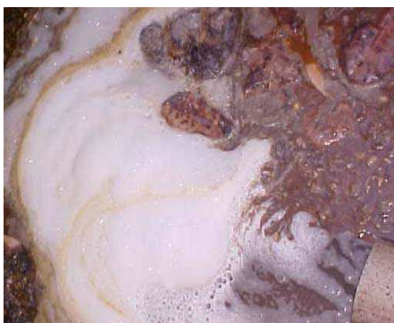
FIGURA 7.5 – Caixa de gordura
