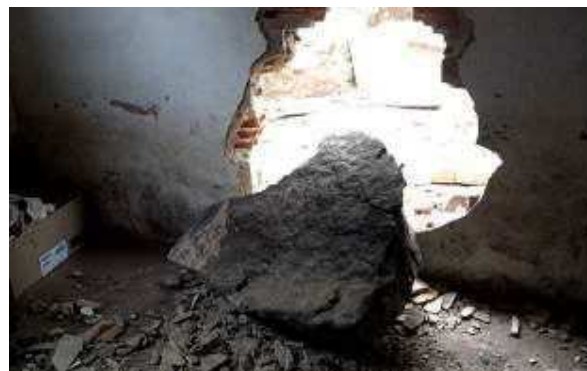
Figura 44 – Bloco de rocha invade residência Fonte: Colturato (2013).
