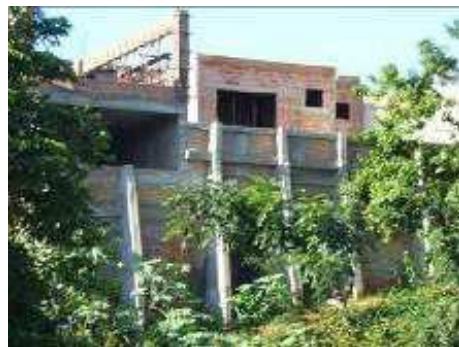
Figura 86b – Edificação em construção no trecho 04 margem esquerda. Imagem ampliada. Fonte: Foto da autora (2015).
