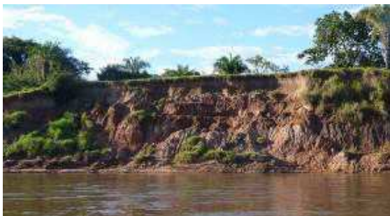
Figura 77 – Erosão na margem esquerda do trecho 03 do rio Garças Fonte: Foto da autora (2015).
