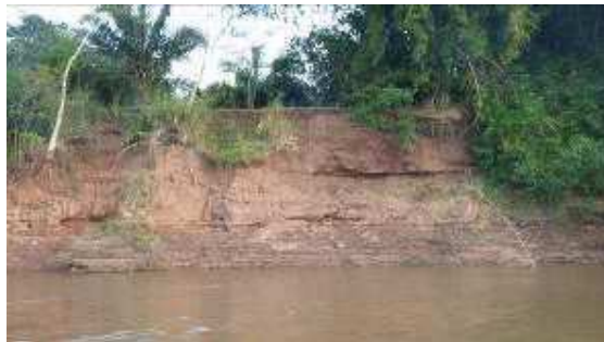
Figura 92 – Erosão na margem direita do trecho 04 – Rio Araguaia.
