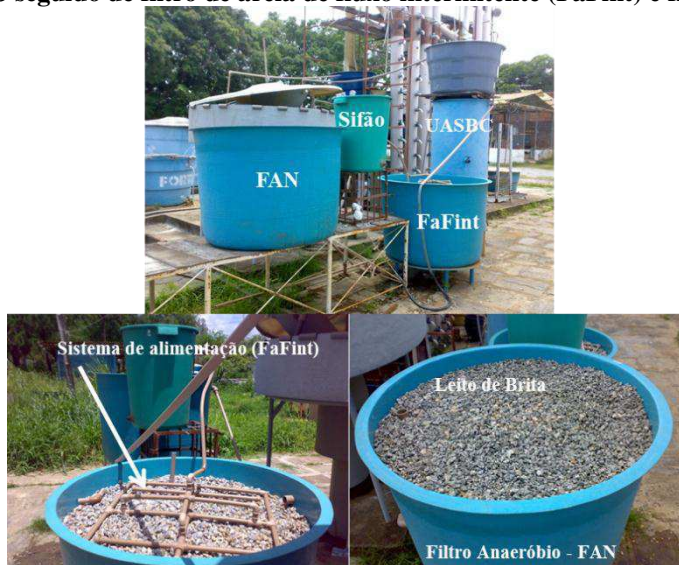
Figura 3.6 – UASB C seguido de filtro de areia de fluxo intermitente (FaFint) e filtro Anaeróbio (FAN)
