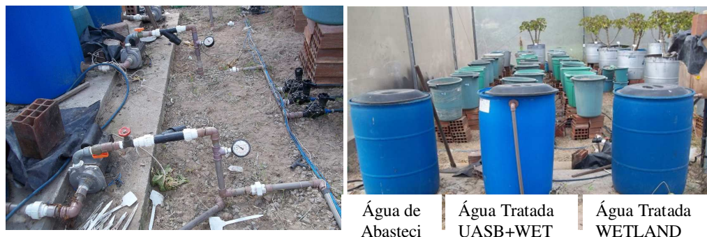
Figura 10 - Sistema de Irrigação Pressurizado com detalhe de eletrobombas, tubulação de saída, registros, manômetros e linhas laterais.
