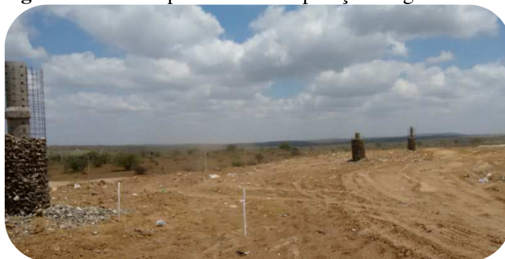
Figura 7. Sistema passivo de recuperação de gás de aterro
