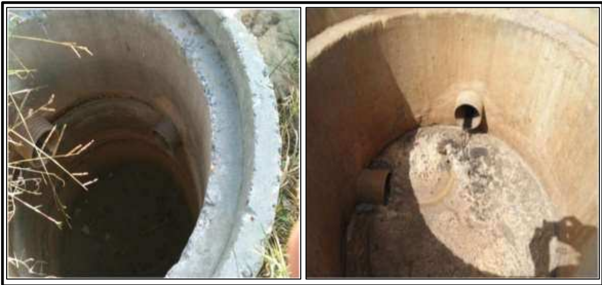
Figura 94: Coletor de chorume em inspeção técnica realizada em 29/11/2011, estando este vazio (à esquerda); coletor durante a inspeção técnica de 10/04/2012, com uma vazão contínua (à direita). Fonte: Paraíba (2012b).
