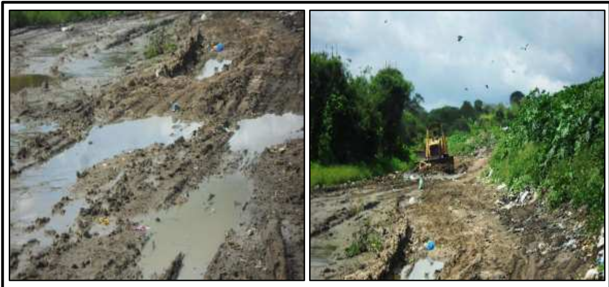
Figura 105: Condições da estrada de terra que dá acesso ao local do lixão, com destaque para a presença de máquina utilizada para melhoria do acesso, assim como para o espalhamento dos resíduos.
