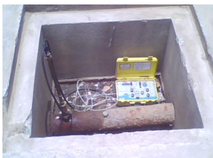
Figura 16 – Foto instalação maleta Lamon
