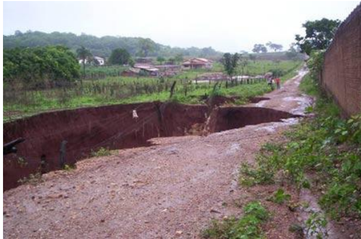
Figura 11 - Foto de subsidência
