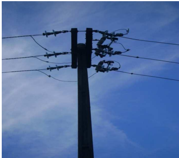
Figura 2.01 – Chave Fusível na entrada do setor B.
