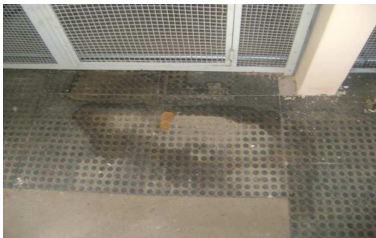
Figura 3.01 – Infiltração na Cabina de Medição.
