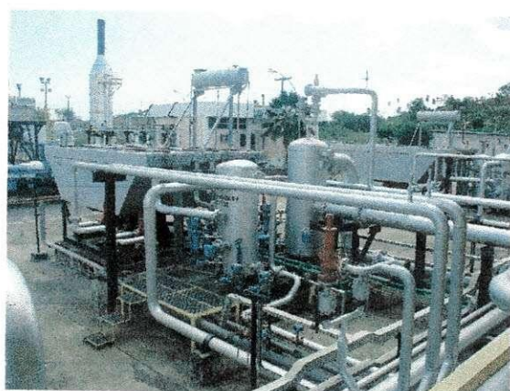
Fig. A8 - Cooler dos estágios de compressão do gás.
