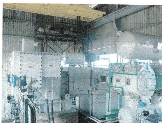
Fig. A10 - Vista geral das máquinas responsáveis pelo processo de compressão de gás.
