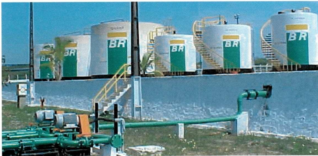
Figura 02: Tanques de armazenamento de óleo e água produzida
