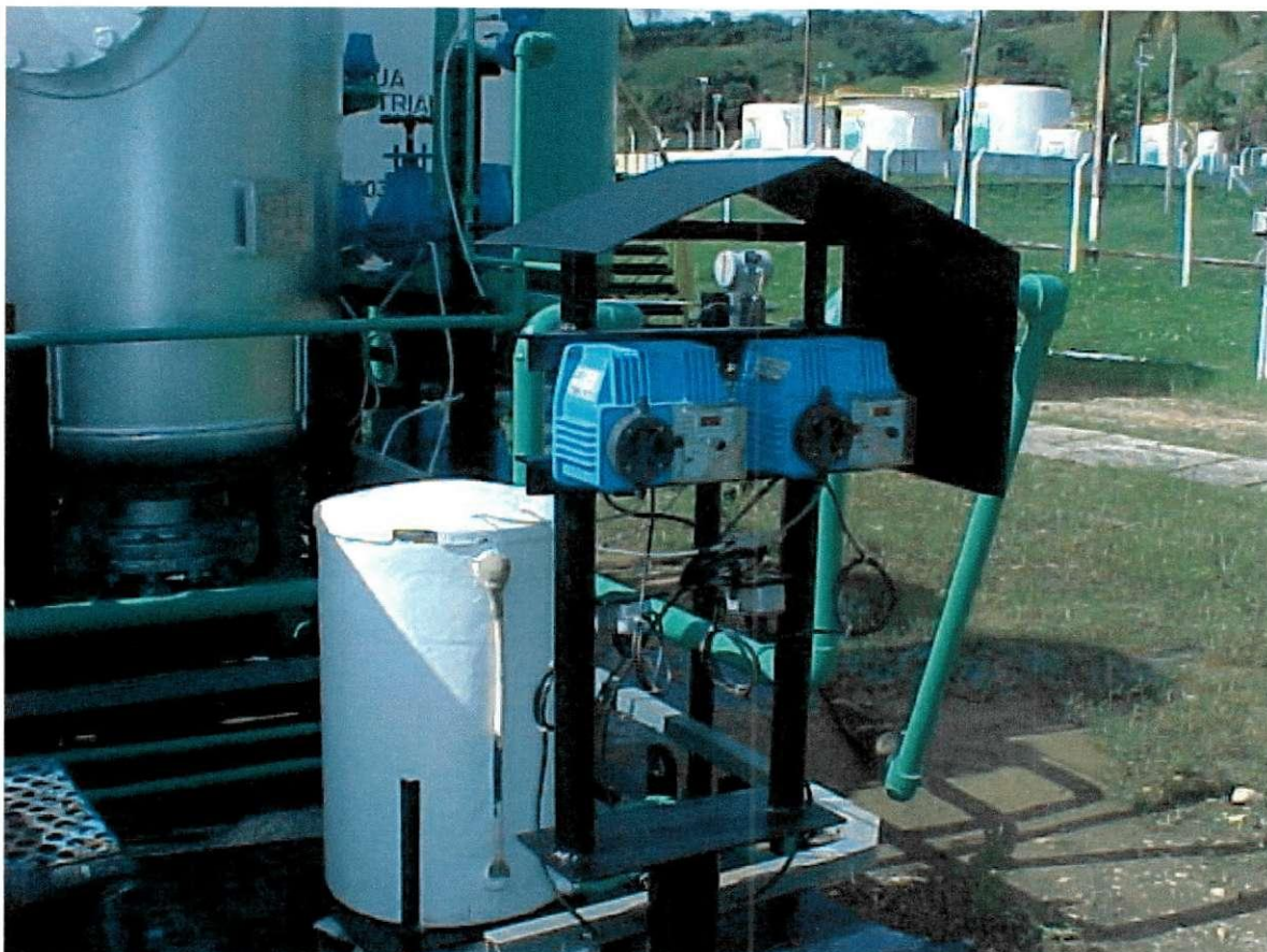
Figura 07: Bombas dosadoras de produtos químicos
