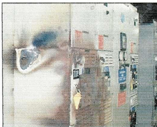
Figura 1.2 – Danos causados a um switchgear devido ocorrência de arco elétrico.
